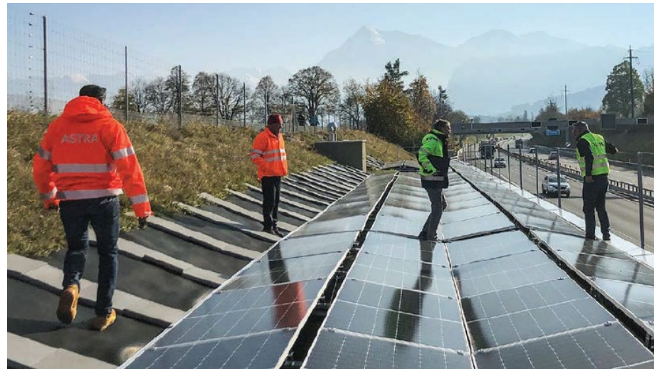
Die Photovoltaik-Anlage auf dem Gebäude der Zentrale des Allmendtunnels in Thun.
